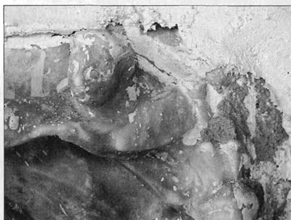
Fot. 17 - En la imagen se puede ver cómo los bordes de la obra están ocultos bajo mortero cemento y capas de cal.
